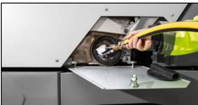
Bild: Rengöring återvinningssystem
